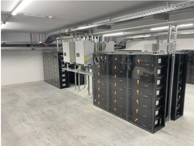
Abb. 2 Die modularen Batteriespeicher im Projekt Haid-Power werden durch Photovoltaik aufgeladen und ins Energiemanagement-System eingebunden. Das System ist in der Lage, auftretende Lastspitzen durch Drosselung der Ladeleistung zu begrenzen.
